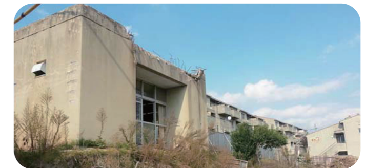
▲土砂災害を受けた県営住宅の現状
