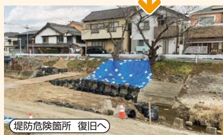
音羽川 堤防崩壊危険箇所
